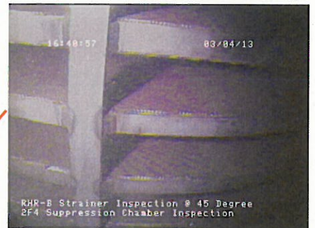
残留熱除去系（B）吸込ストレーナ
