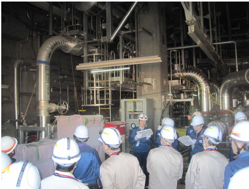
非常用ディーゼル発電設備 冷却系〔復旧〕 (4号機海水熱交換器建屋)
