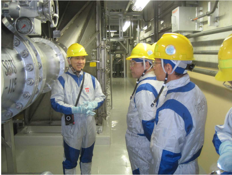
4号機非常用ガス処理装置 (原子炉建屋内)
