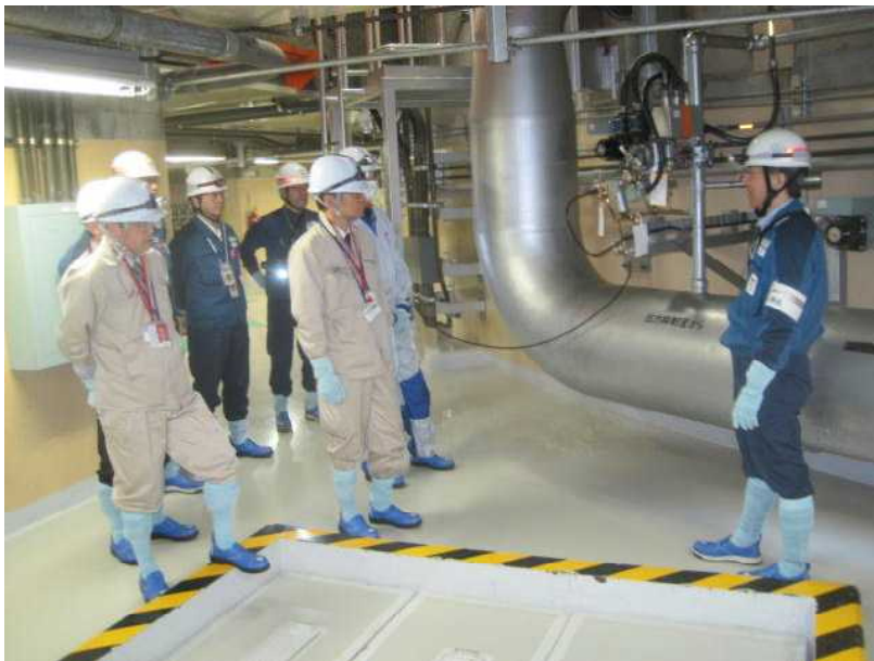
1号機ベント配管 (原子炉建屋内)
