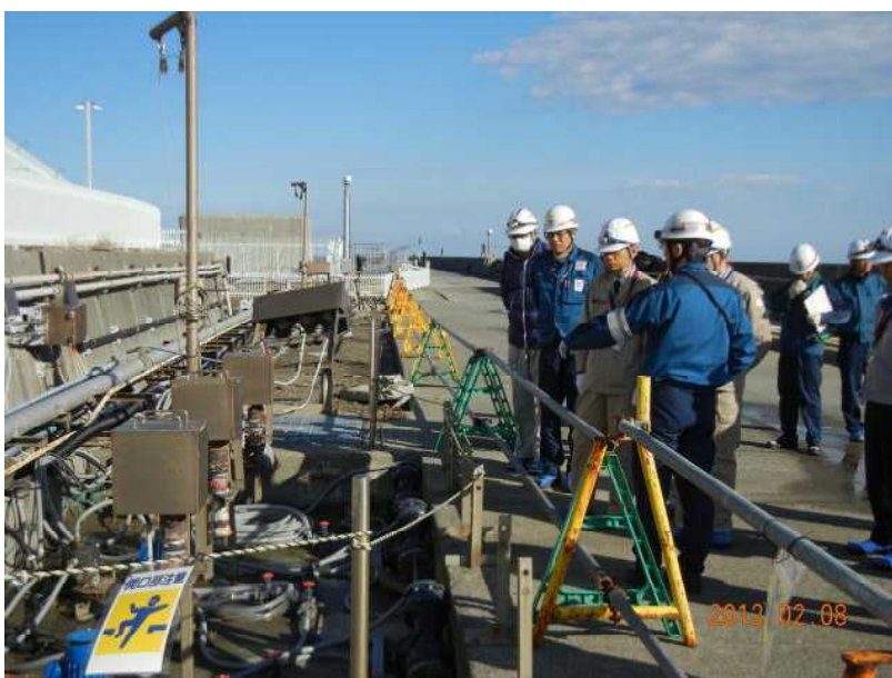
南放水口放射線モニタの サンプリングポンプ [仮設]
