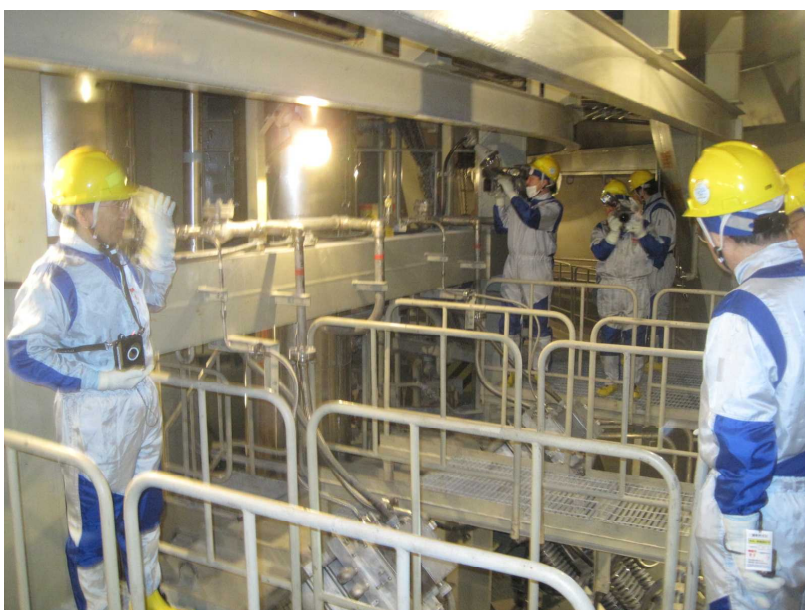
4号機主蒸気隔離弁 (原子炉格納容器内)
