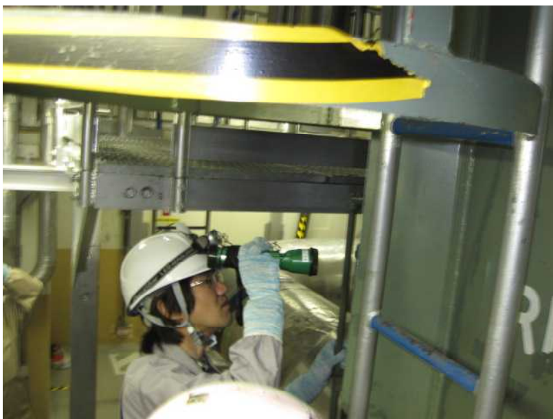
1号機残留熱除去系ポンプ (原子炉建屋内)
