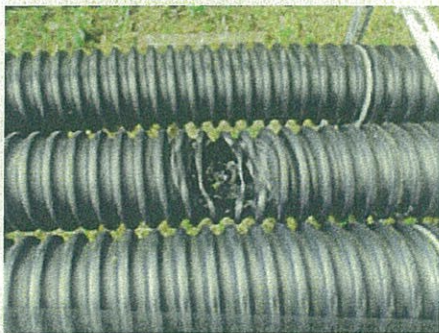
写真1. 損傷したケーブルの状況
