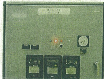
写真2. 復電した所内共通M/Cの状況
