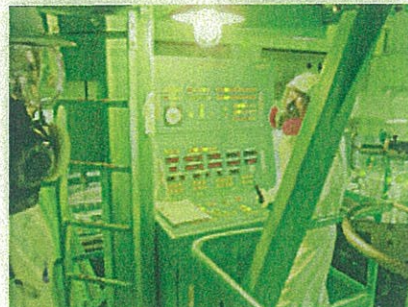
燃料取扱機の機上操作卓にて燃料のつかみ状態・方向等を操作確認している状況。
