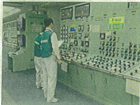
海水系統の運転状況を確認
