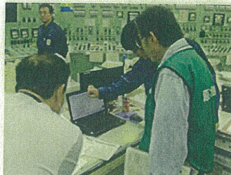
6号機中央制御室にて記録状況を確認
