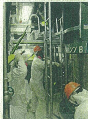
残留熱除去ポンプ(B)運転状況を確認
