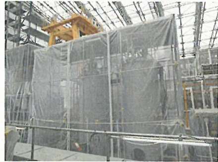
吸着塔 (処理カラム) 平成25年3月27日撮影
