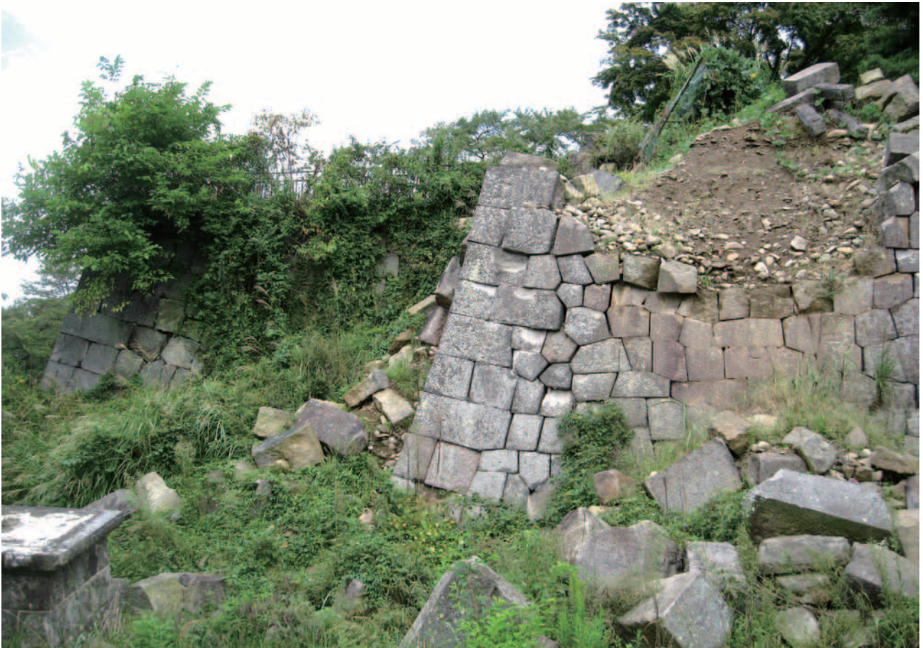
白河市小峰城石垣崩壊状況 平成 24 年 9 月 22 日撮影
