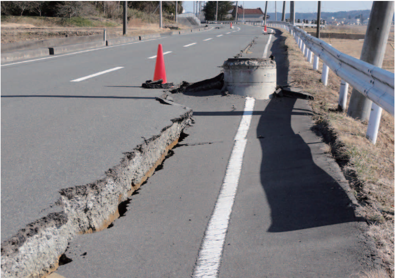
南相馬市道路被災状況 平成 23 年 3 月 12 日撮影
