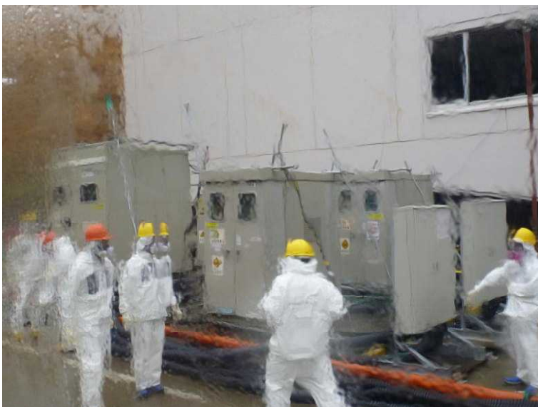
○1・2号機使用済燃料 プール電源切替盤
