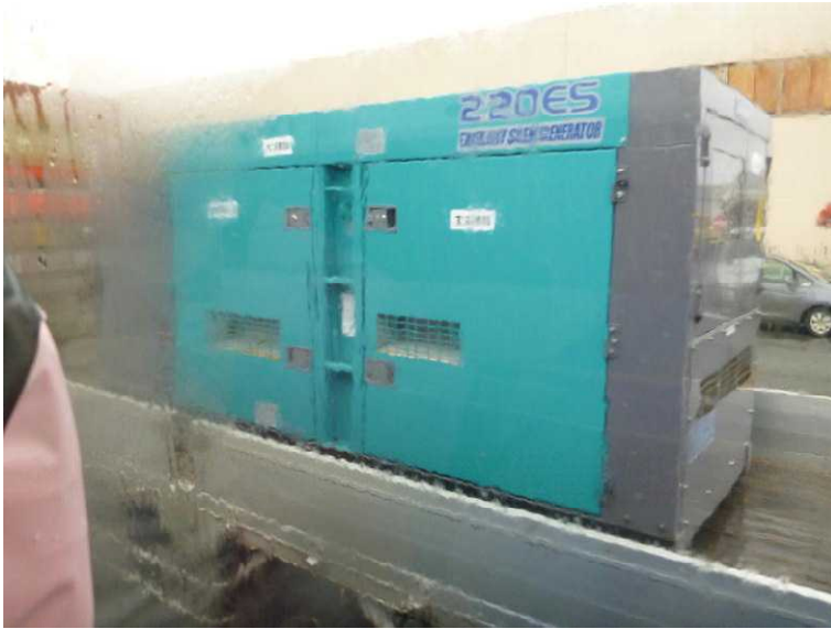
○仮設ディーゼル発電機
