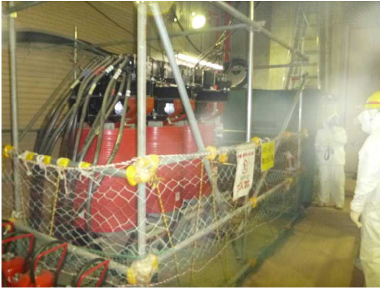
○共用プール仮設P/C
