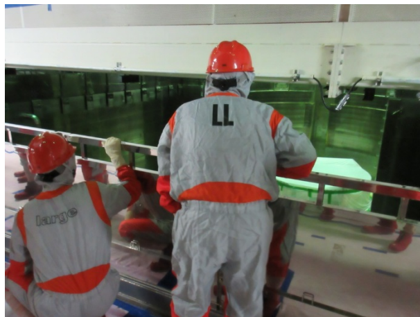
使用済燃料プールゲート閉止状況の確認
