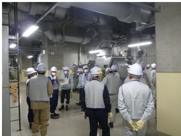
排ガスブロア
