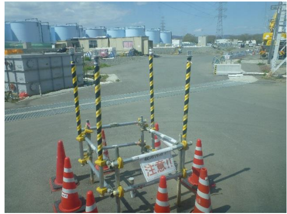
地下貯水槽の漏えい監視用地下水観測孔
