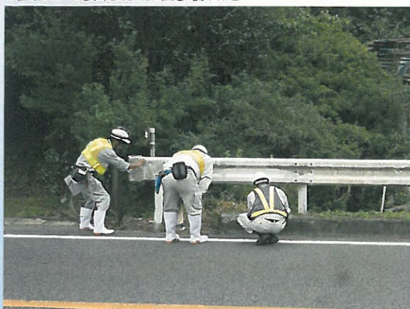
路面の損傷確認状況
