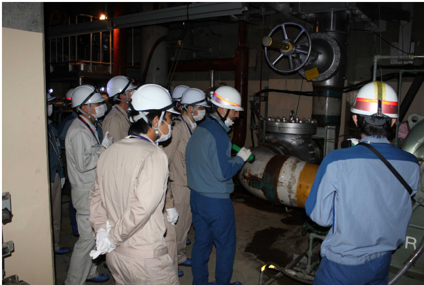
原子炉隔離時冷却系 (2号機原子炉建屋地下 2階)
