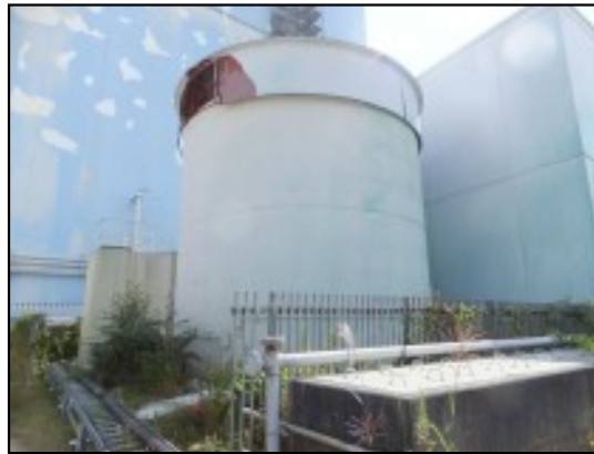
②廃液サージタンク
