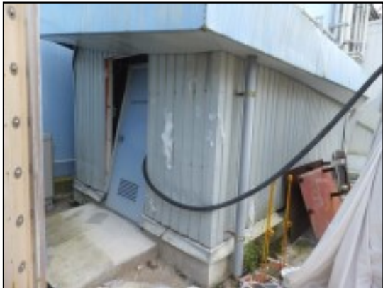
⑤MS/SRV窒素ガスポンベ室
