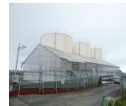
③集水タンク (3基)
