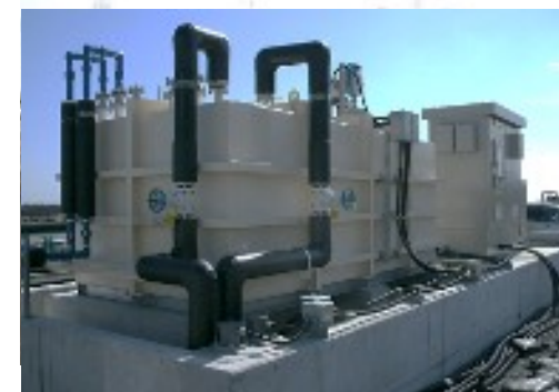
②地下水ドレン中継タンク (3基)
