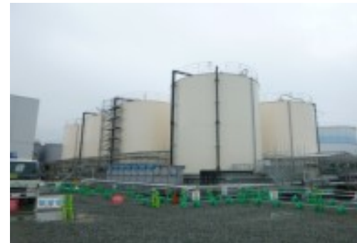
⑥一時貯水タンク (7基)
