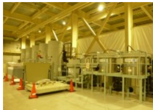
④サブドレン他浄化設備
