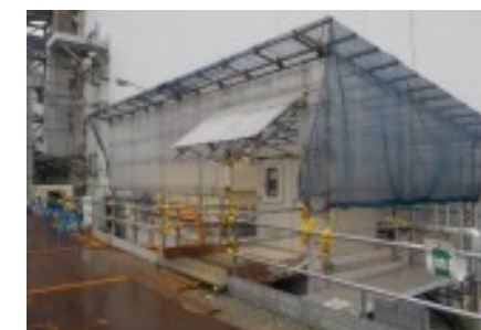
②サブドレン中継タンク (5基)
