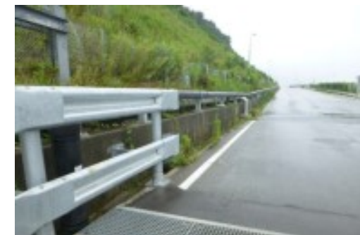
③排水配管
