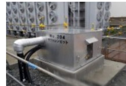
①サブドレンピット (41カ所)
