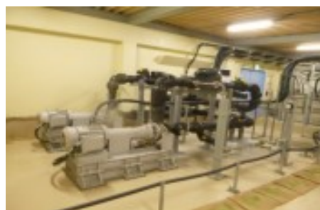
②移送ポンプ
