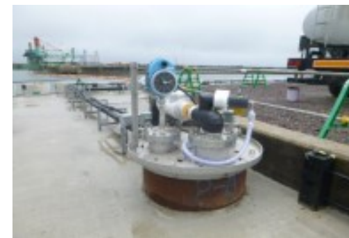
①地下水ドレンポンド (5カ所)
