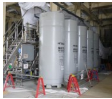
浄化設備（吸着塔）
