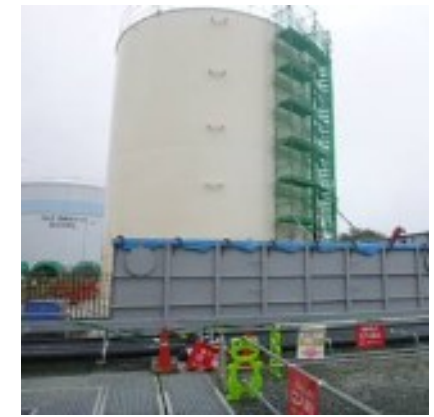
一時貯水タンク
