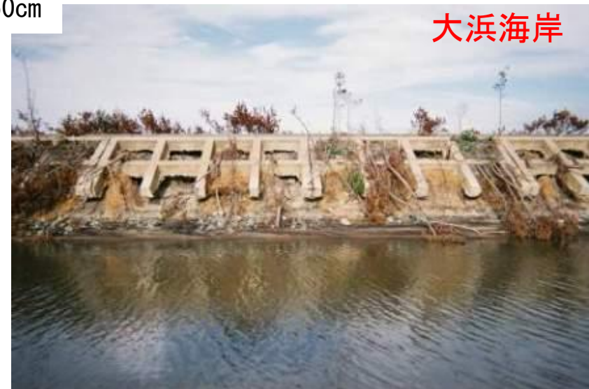
法枠構造の裏法の被災例
