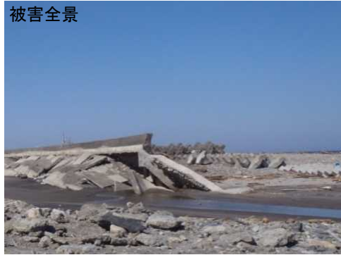
海岸堤防の被災状況
