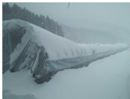
降雪で倒壊したパイプハウス
