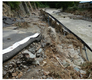
林道矢竹阿多根線 路面流出被害
