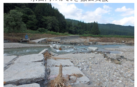
竜伏堰地区 頭首工被災
