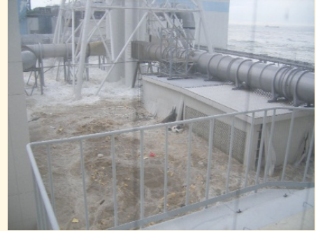
津波被害を受ける発電所
