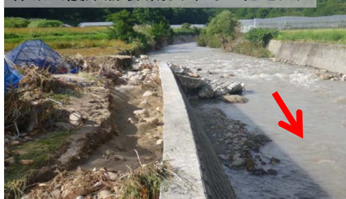
保城川護岸崩壊(南会津町八総地内)
