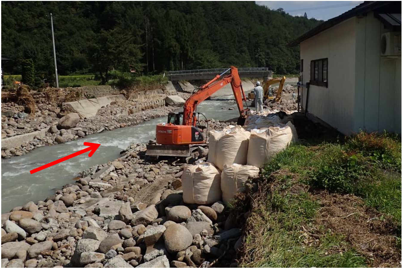
桧沢川護岸崩壊箇所での大型土のう設置状況（南会津町静川地内）
