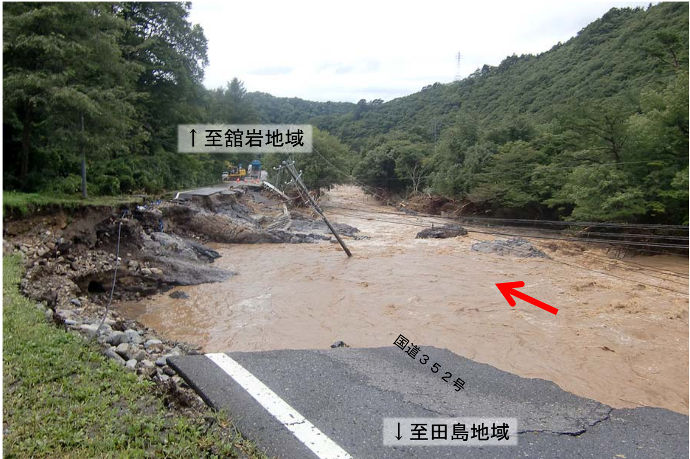
国道352号道路崩壊（南会津町戸中地内）
