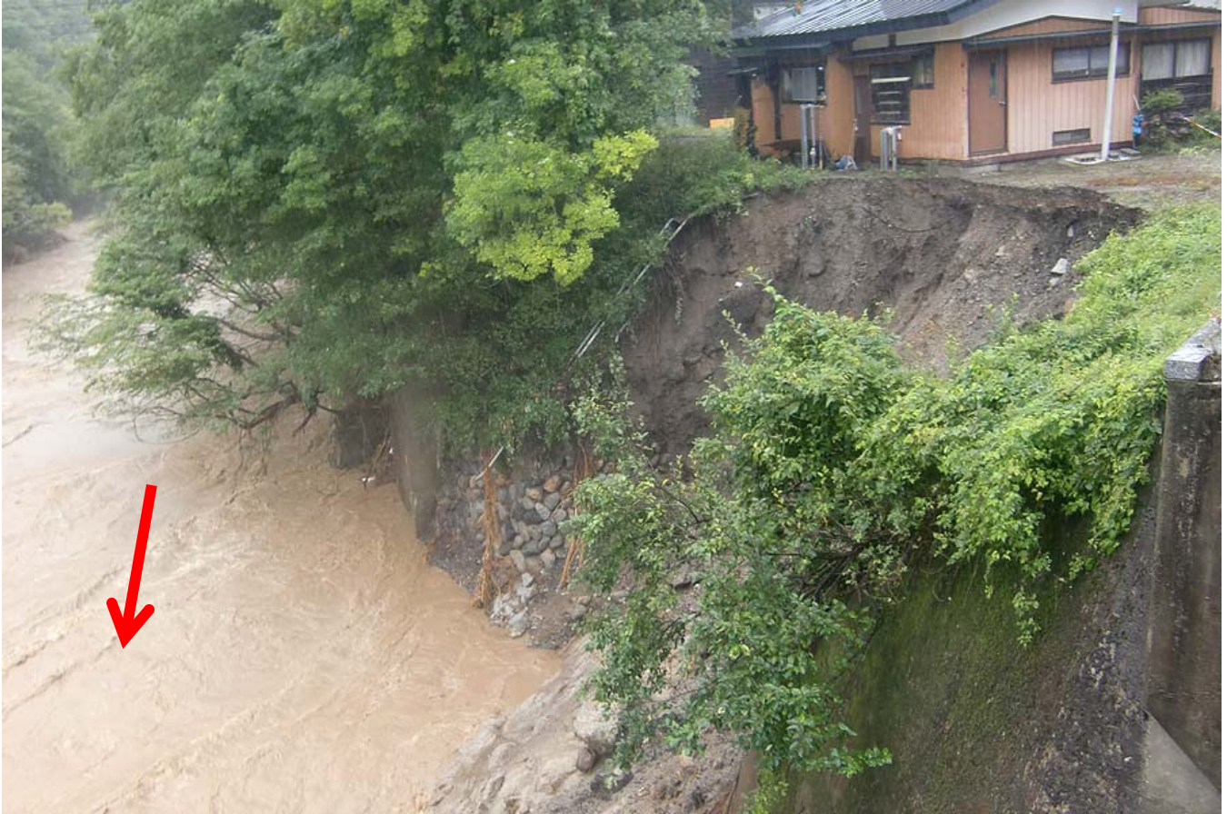
館岩川護岸崩壊（南会津町松戸原地内 穴沢橋付近）
