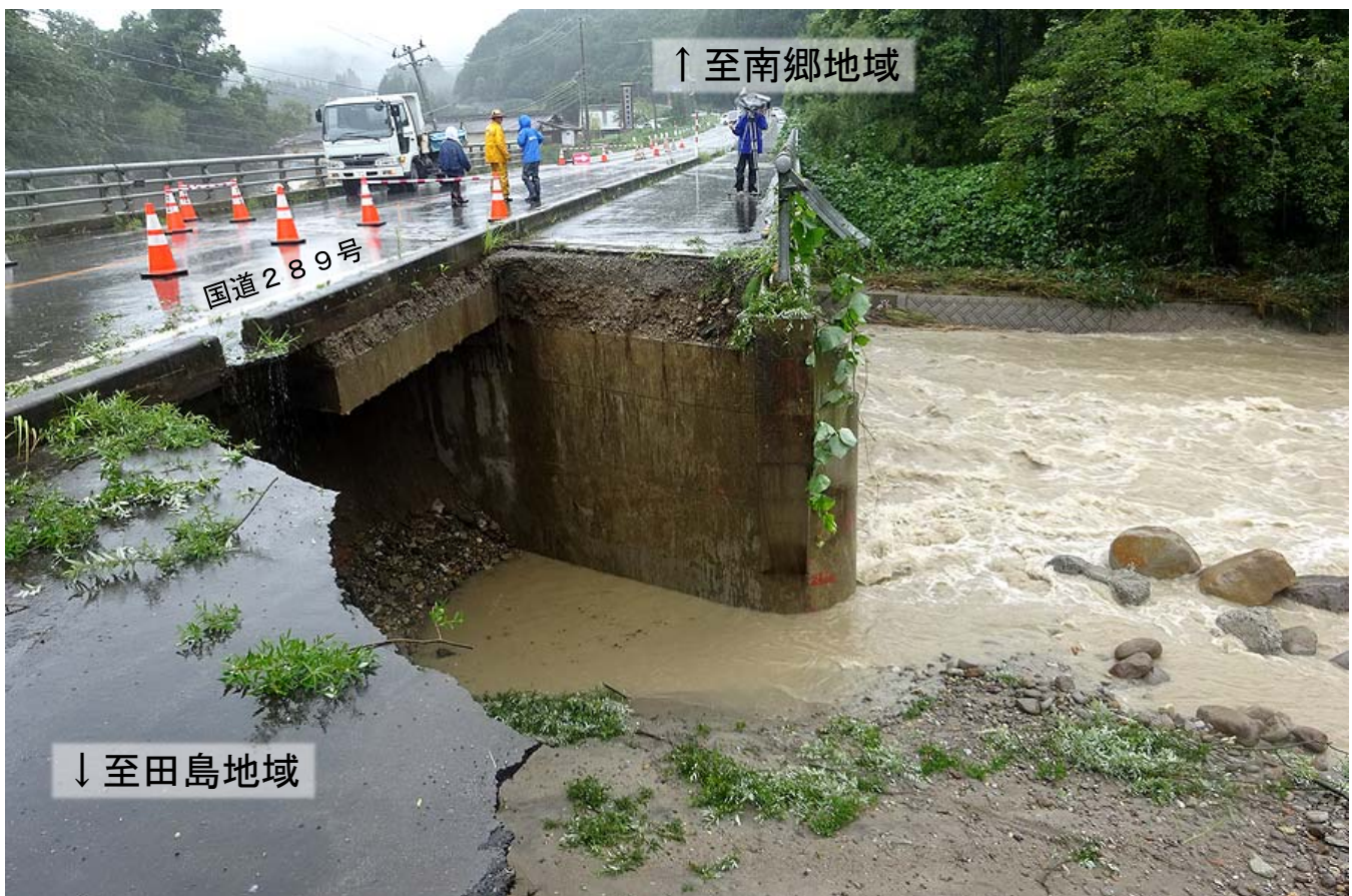
国道289号道路崩壊（南会津町黒森沢橋付近）
