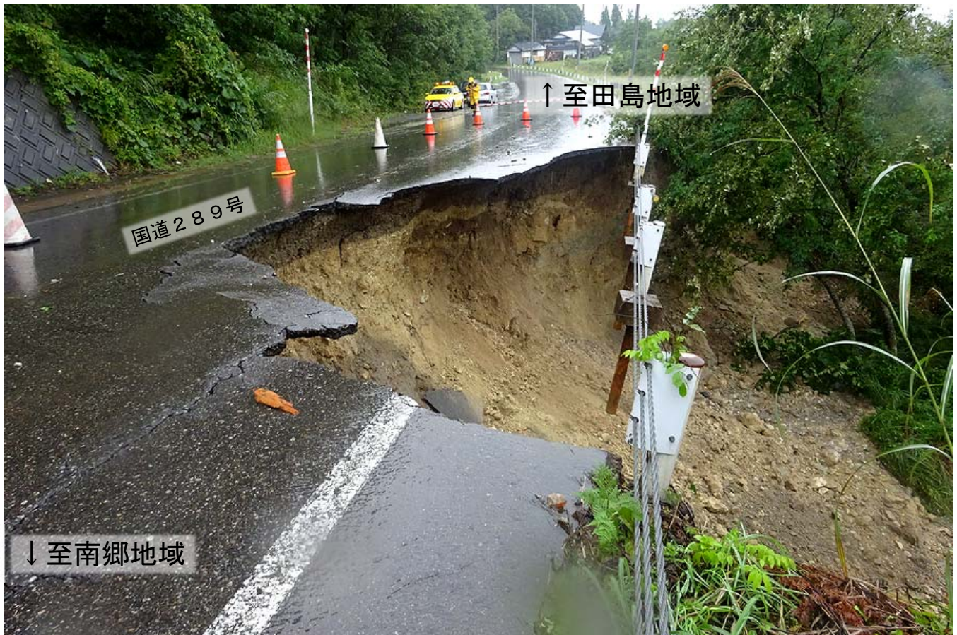
国道289号道路崩壊（南会津町駒止山地内）
