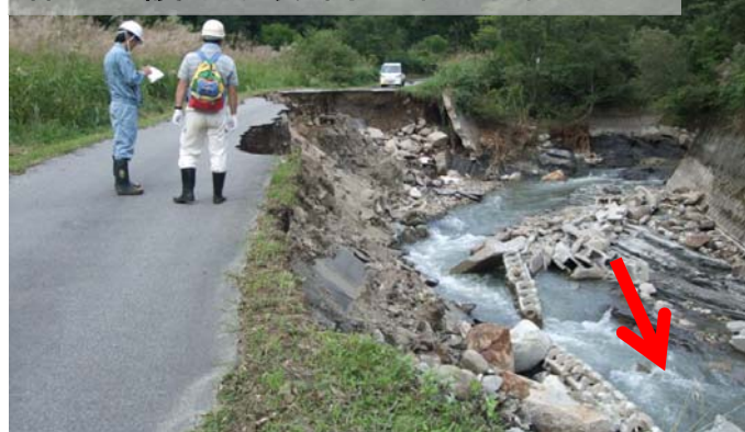
保城川護岸崩壊(南会津町八総地内)
