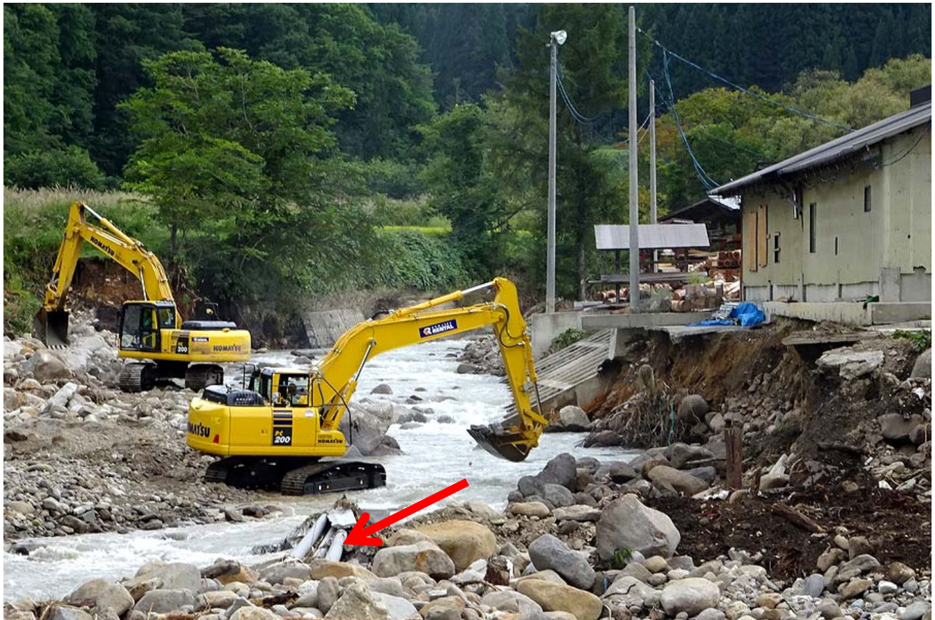
桧沢川護岸崩壊箇所での河道整正作業状況（南会津町針生地内）
