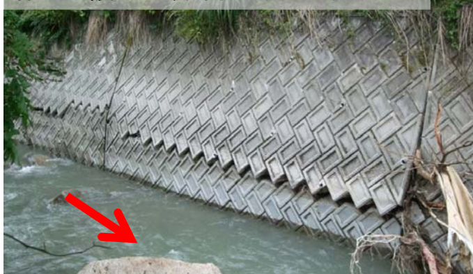
保城川護岸崩壊(南会津町八総地内)
