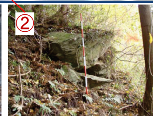
↑落石の危険有り
