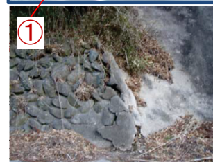
↑すりつけ部の劣化
