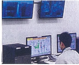
制御室 試験作業状況
