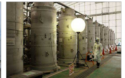
高性能多核種除去設備
