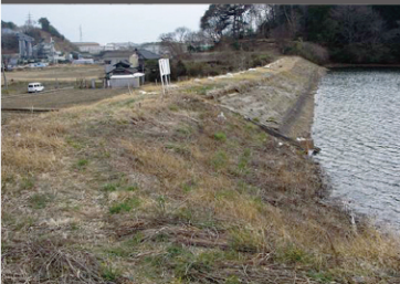
④ 地震による農業用施設被害 (萱手ため池)
