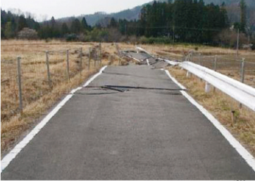
① 地震による農道被害 (小川町 高谷地)
