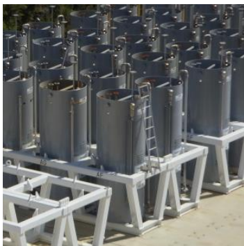
第二セシウム吸着装置 (SARRY) 吸着塔
