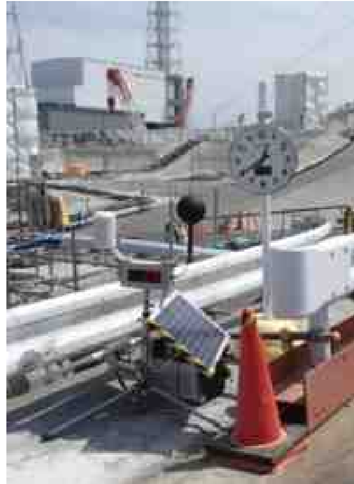
1～4号水素供給装置東側 G⇄Y装備切替所付近
