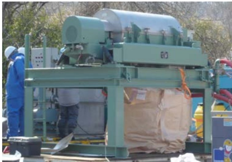
写真2 スクリューデカンタ 脱水処理装置
