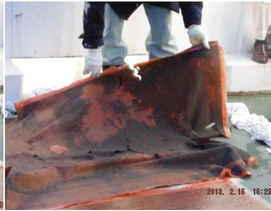
写真4 剥離後の塗膜の裏面
