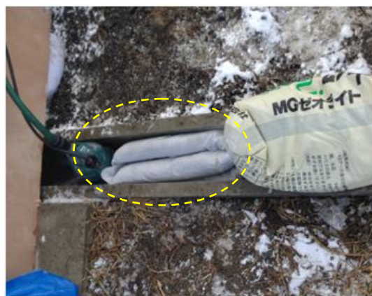
写真8 排水溝に設置したザ・ガードメン
