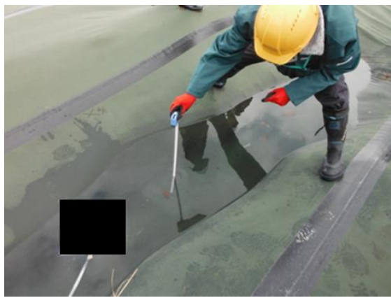
写真3 不陸発生状況確認の様子
