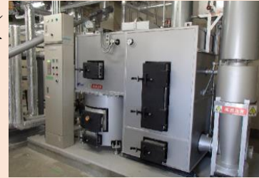
木質燃料を原料としたボイラー整備
