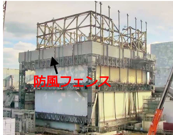
防風フェンス設置状況 (2017年12月19日撮影)
