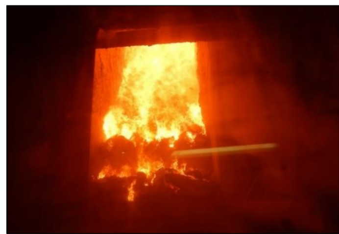
焼却炉内の燃焼状況
