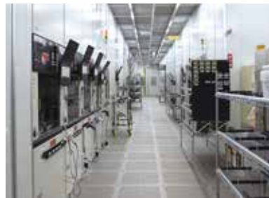
クリーンルーム
