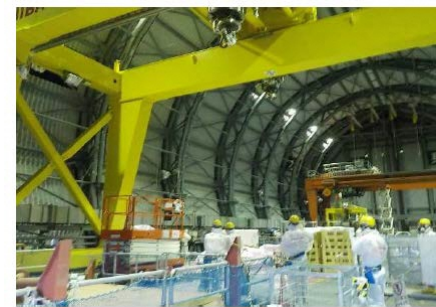
クレーンと燃料取扱機
