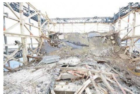
建屋上部のガレキの状況
