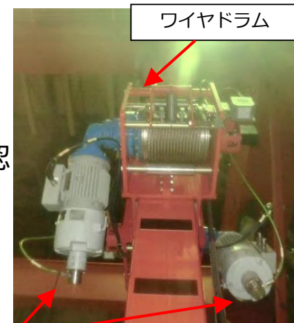
モータ速度検出器 【写真1】
