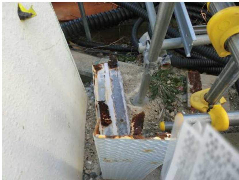
落下した足場
