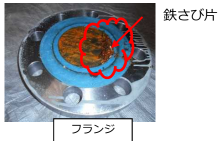
2号機ポンプ(B)吸込ストレーナ
