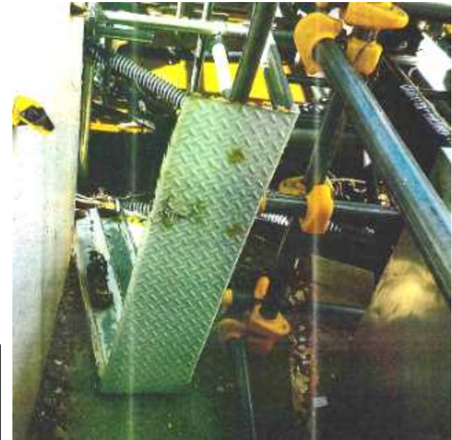
落下した点検用の足場
