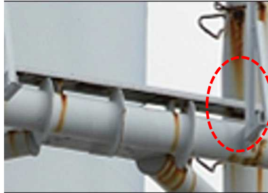
落下前の足場材付近 (地上約76m)
