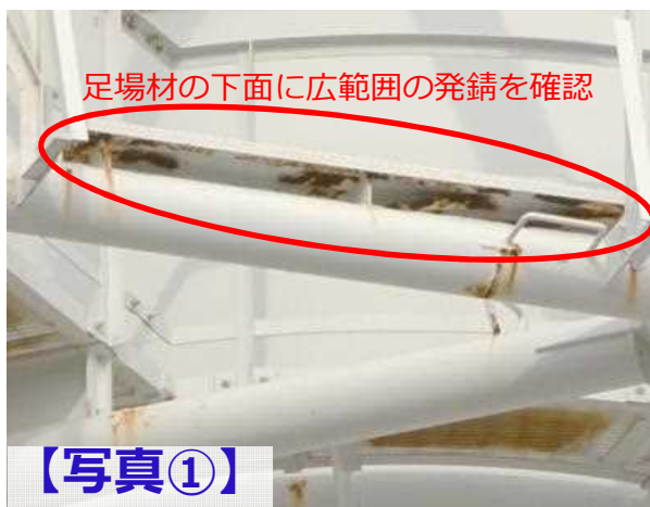
3/4号機 劣化進行が疑われる足場材 南面 地上86m付近
