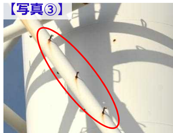
3/4号機 劣化進行が疑われるステップ 東面 地上100m付近
