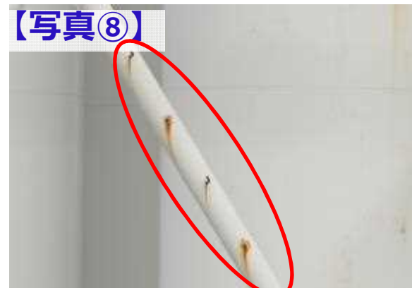
タービン建屋集中 劣化が疑われるステップ 南面 地上32m付近
