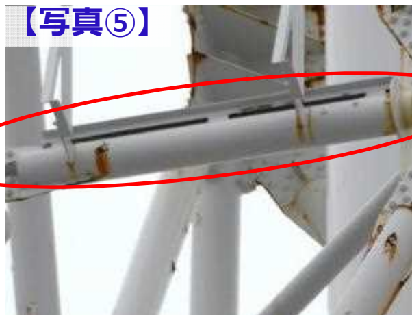
1/2号機 落下しないと推定される足場材 北面 地上100m付近
