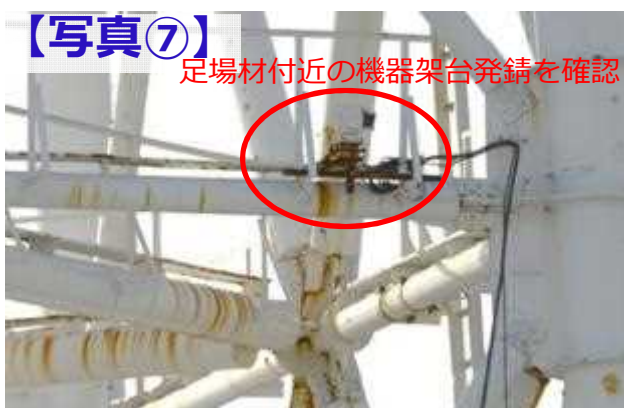
タービン建屋集中 劣化が疑われる機器 北面 地上42m付近
