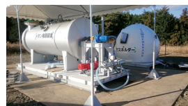
バイオガスプラント
