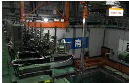
オペレーティングフロアの様子
