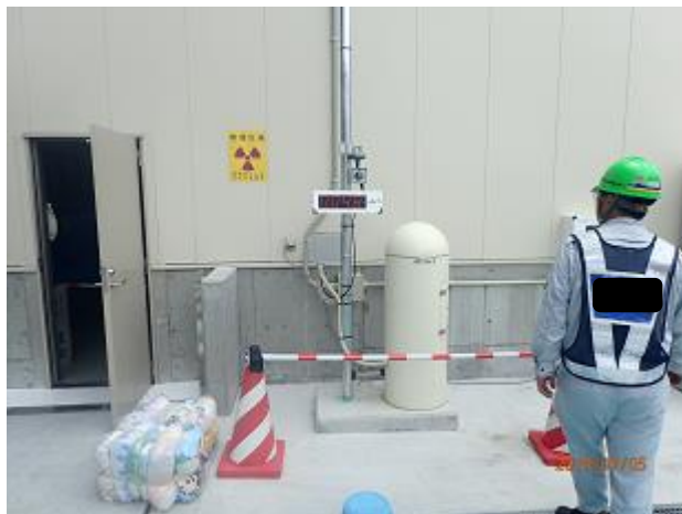
場内設置モニタリングポストの確認
