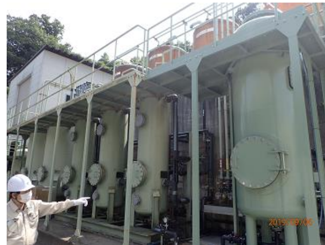
浸出水処理施設の稼働状況の確認
