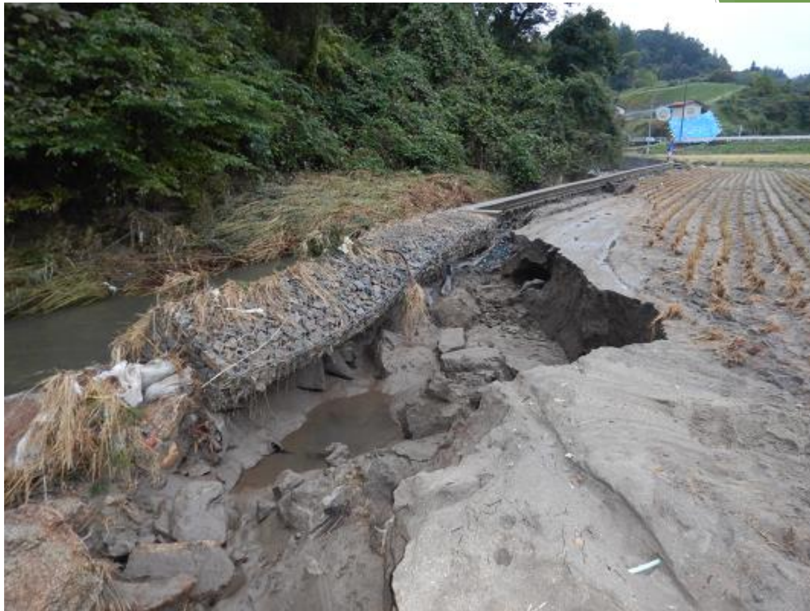
古道川側方浸食（田村市都路町古道付近）
