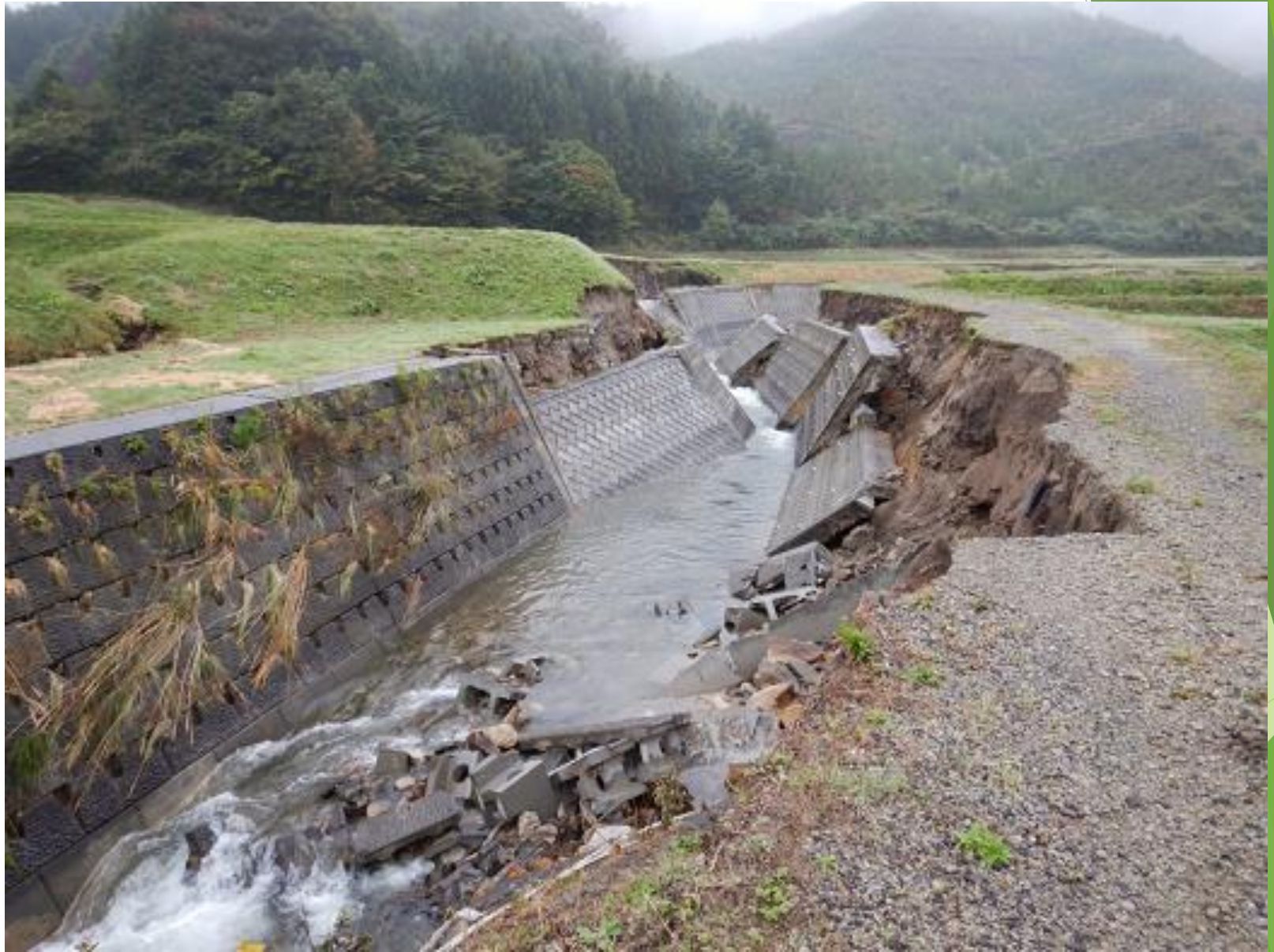
山口川護岸崩落（田村市都路町古町地区）
