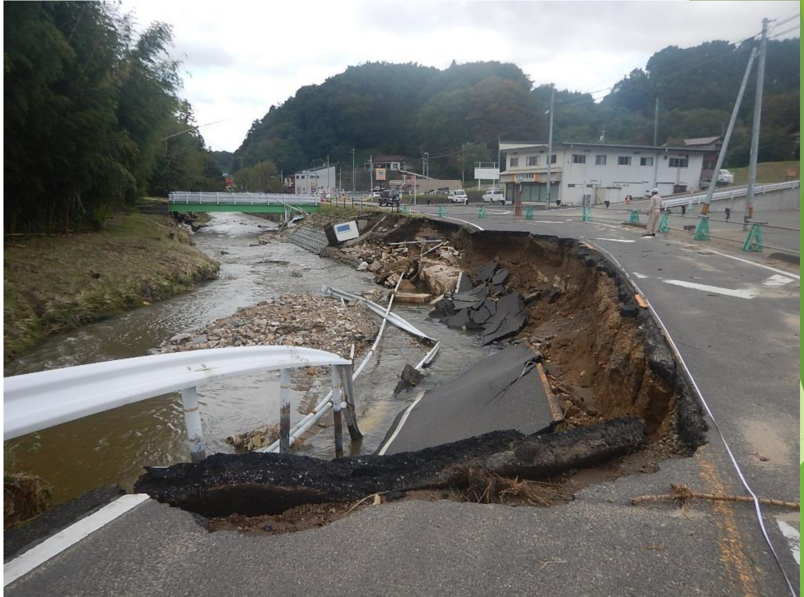
国道288号道路陥没（三春町大字上舞木地区）
