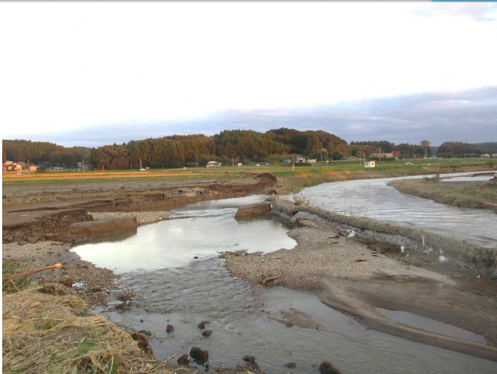
杜川堤防決壊（浅川町福貴作地区）
