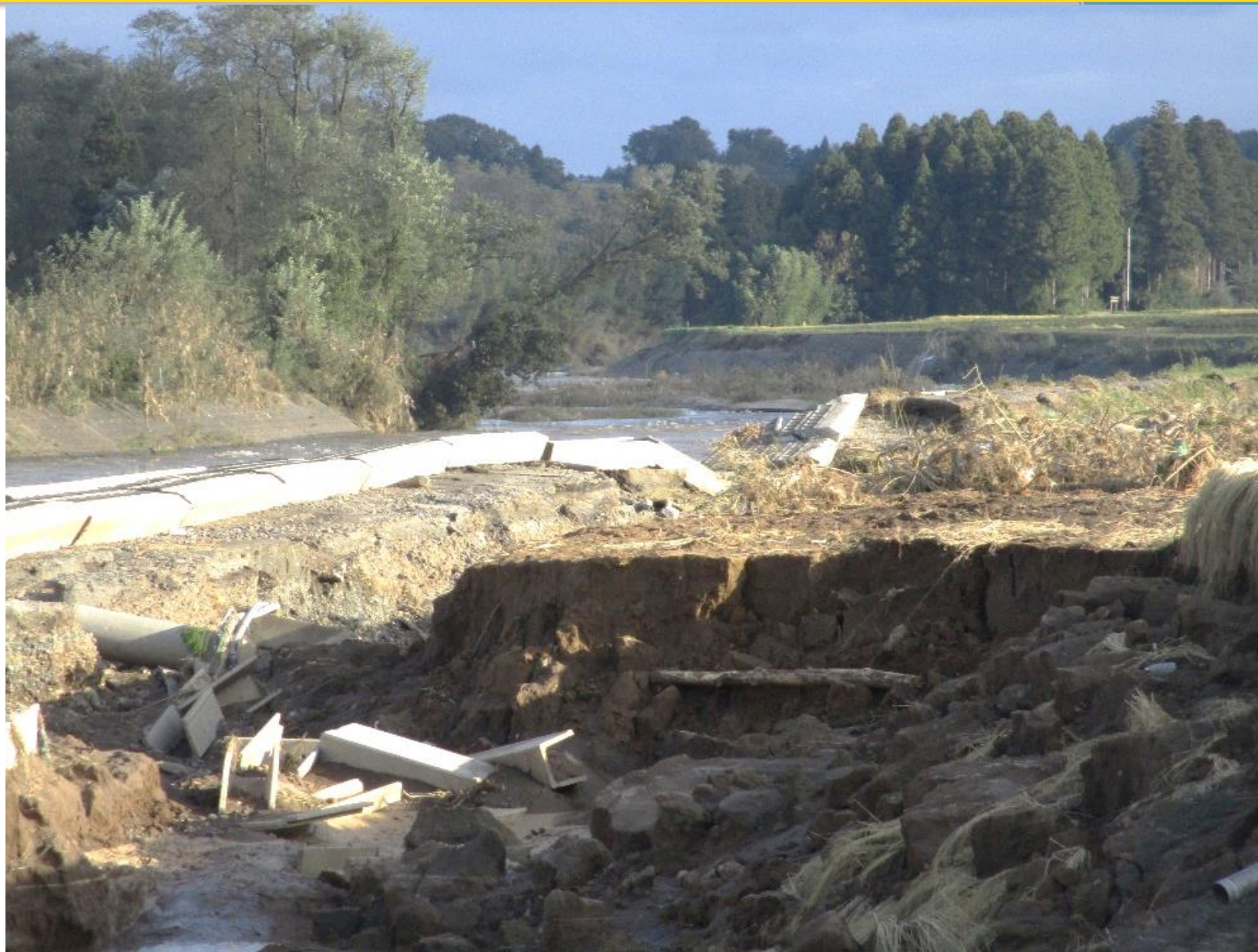
阿武隈川護岸崩壊（矢吹町明新東地区）
