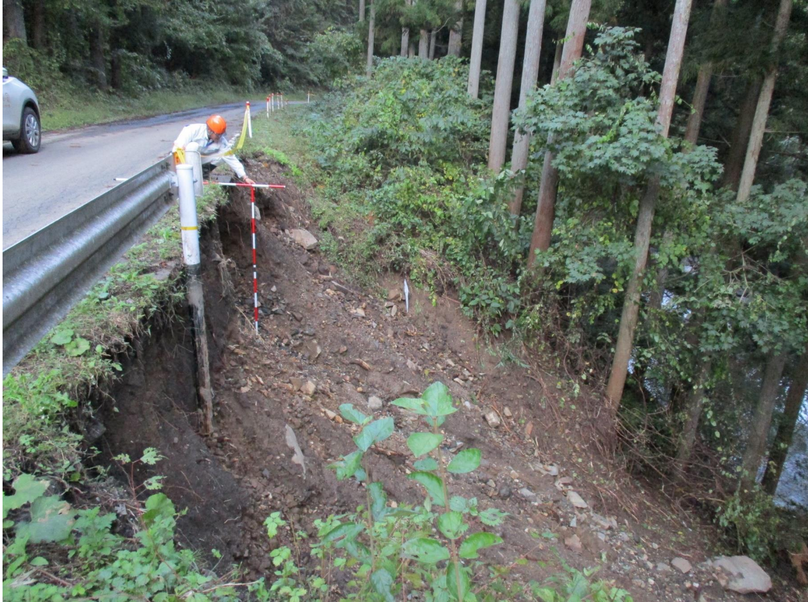
県道三株下市萱小川線道路崩壊（古殿町大字松川字三株地区）
