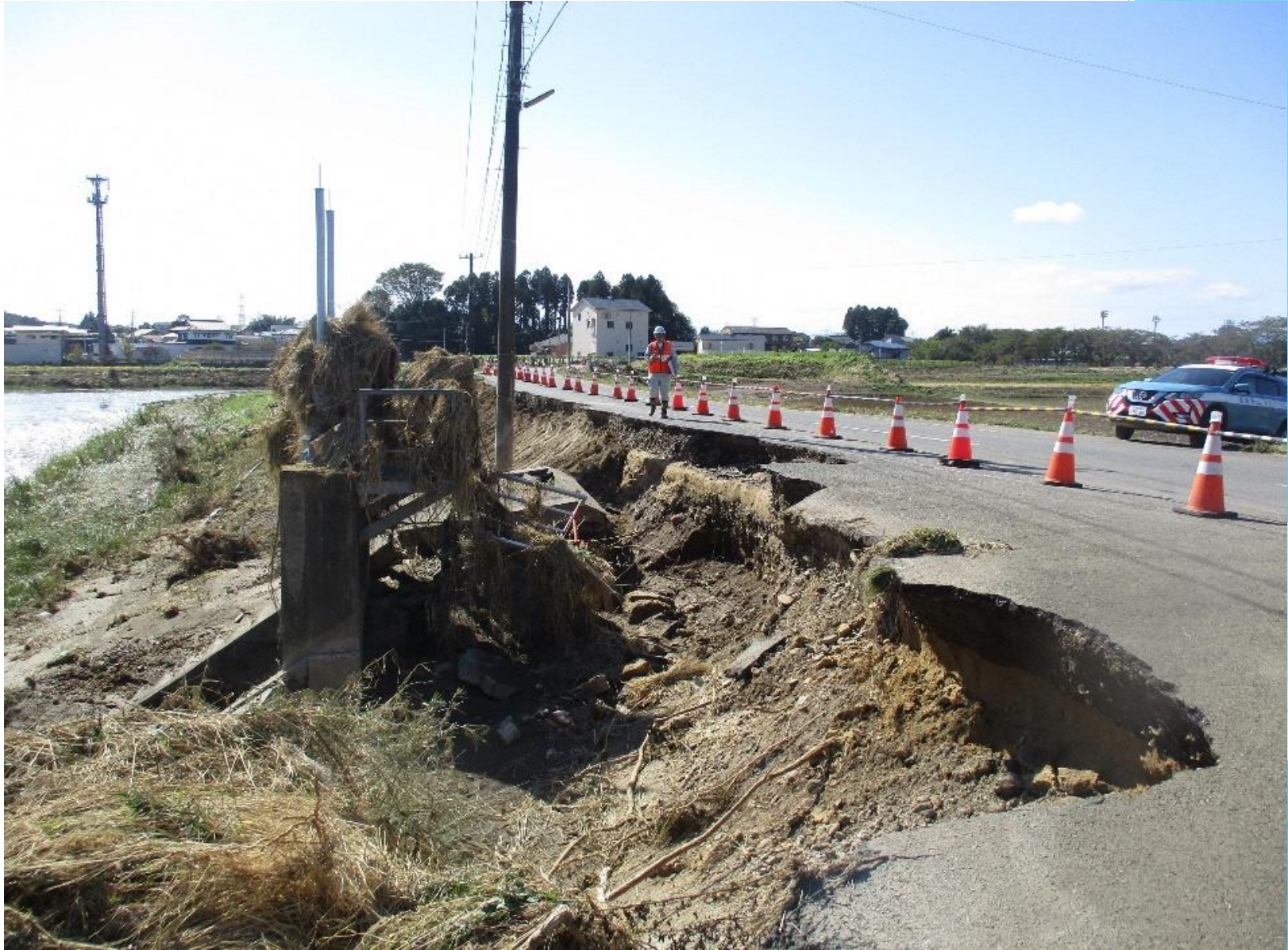
県道塙泉崎線路肩崩壊（浅川町大字滝輪地区）
