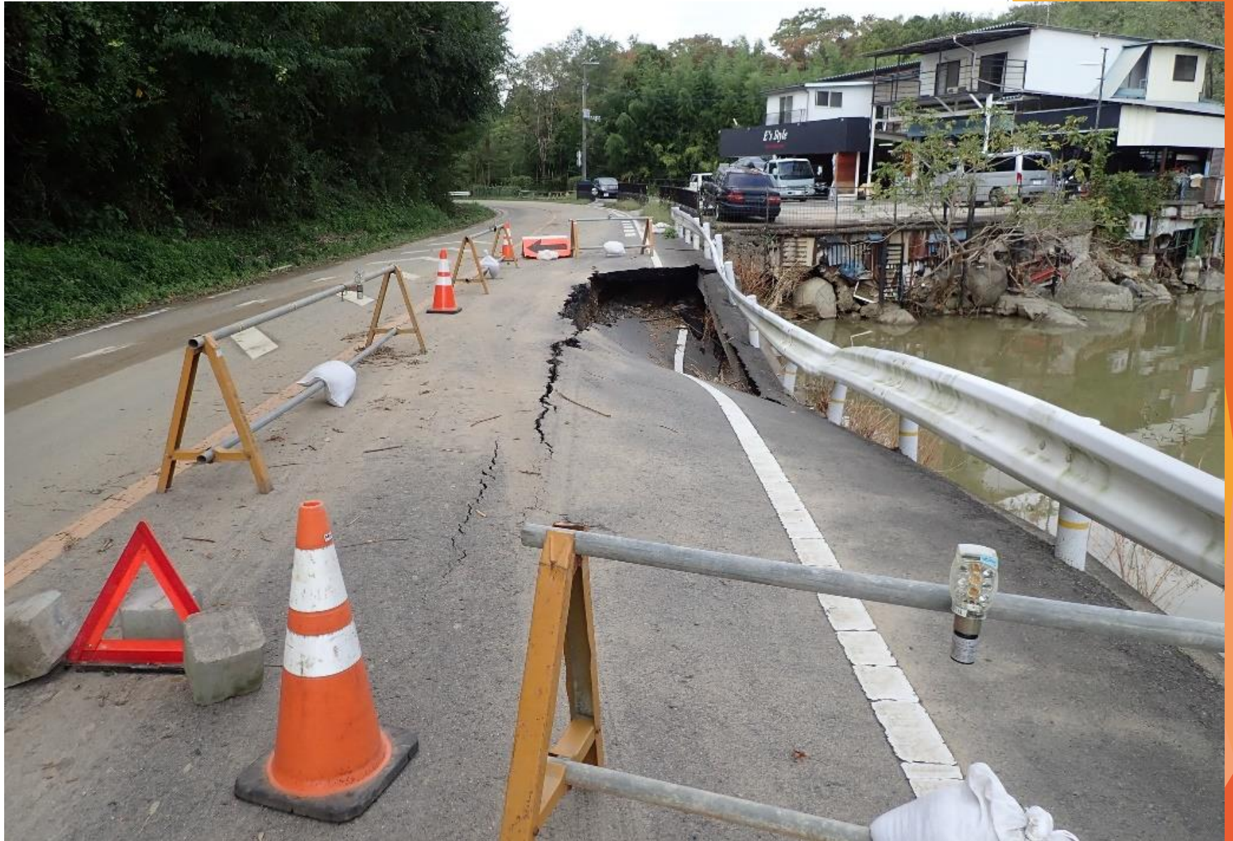
国道288号道路崩壊（郡山市富久山町北小泉付近）
