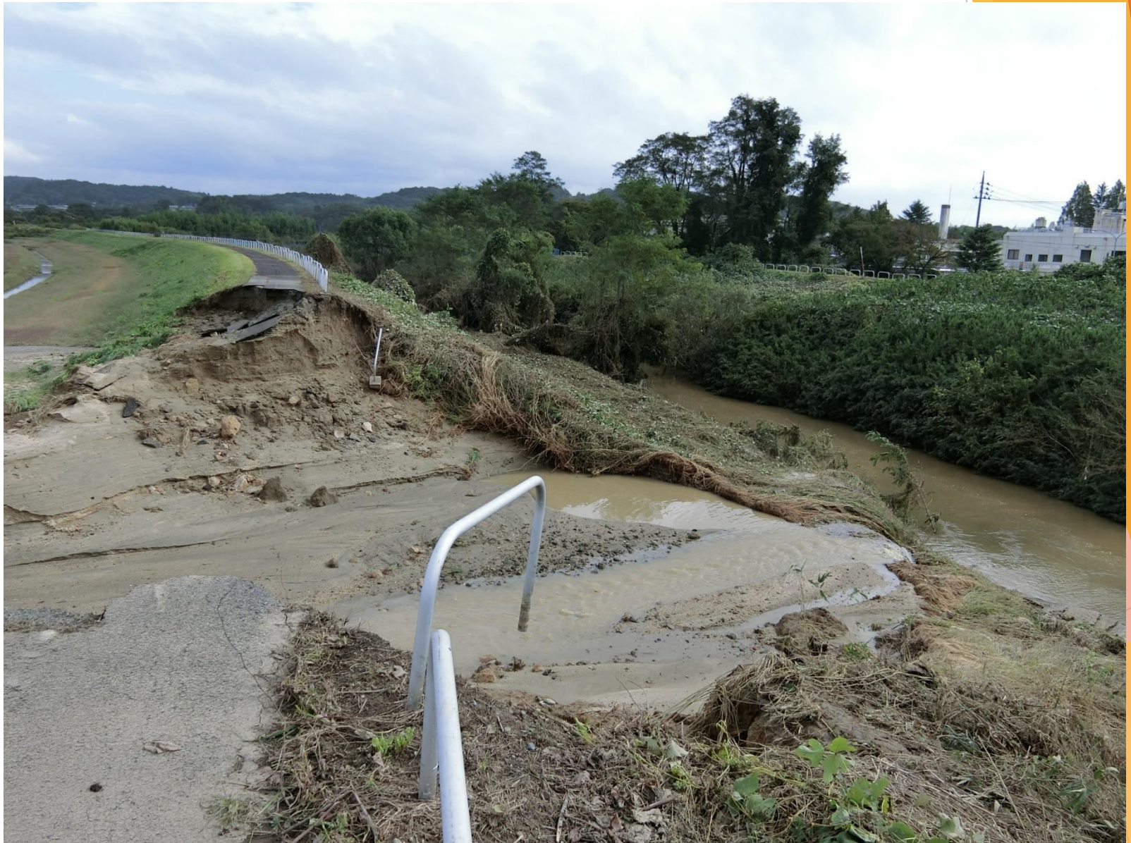
藤田川堤防決壊（郡山市日和田町八丁目付近）
