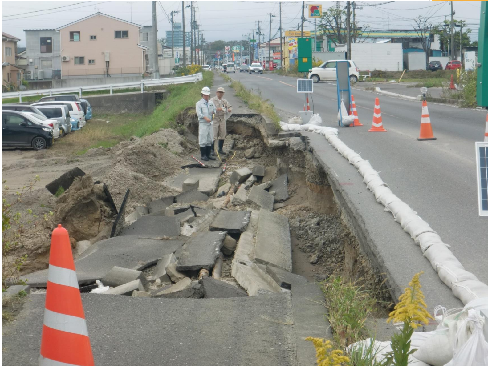
県道郡山大越線道路崩壊（郡山市富久山町久保田付近）
