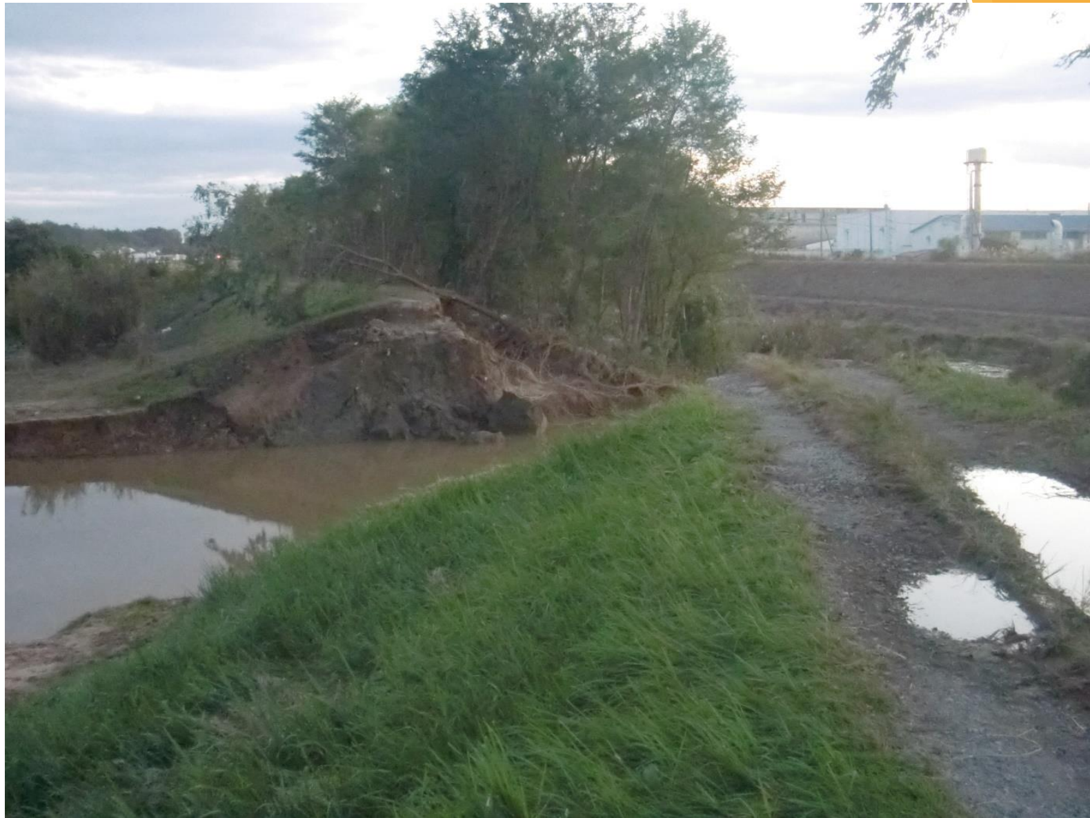
谷田川堤防決壊（郡山市田村町下行合付近）
