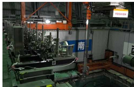
オペレーティングフロアの様子
