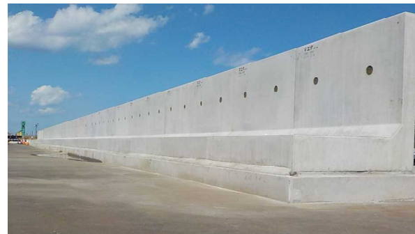
現地据付状況（9月25日撮影） 据付後、基礎コンクリート仕上げを行い、周辺の造成嵩上げとフェーシングを施工する
