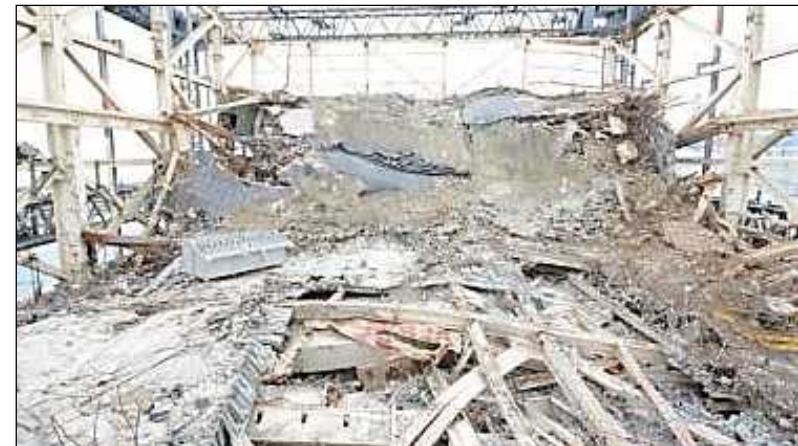
崩落屋根の状況
