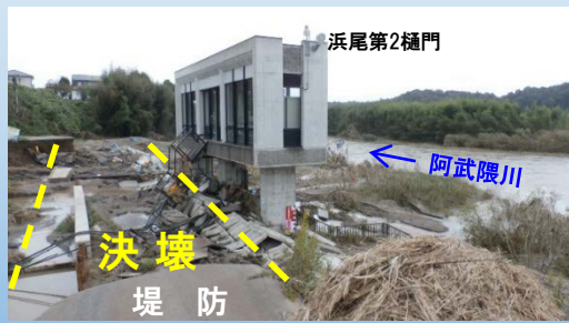
98.6k 左岸堤防決壊箇所(須賀川市)
