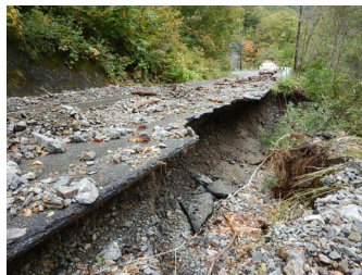
林道 館岩・檜枝岐線 路側決壊被害
