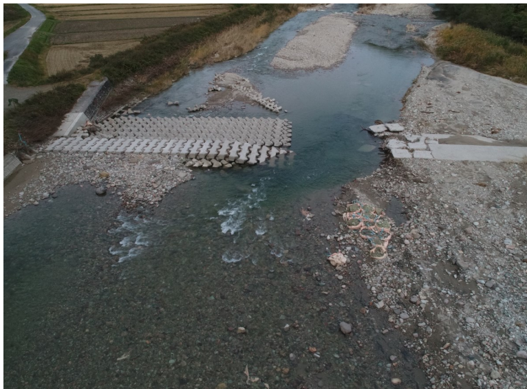
南会津町 龍伏堰の被害
