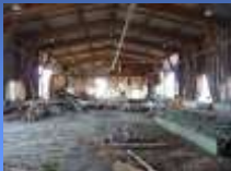
津波被害を受けた製材工場
