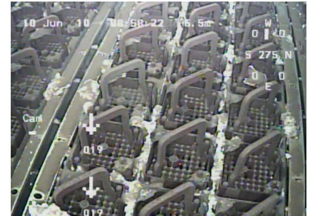
SFP※内の燃料、燃料ラック上部の様子
