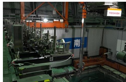
オペレーティングフロアの様子
