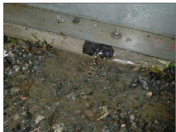
H5エリア西側の漏えい状況
